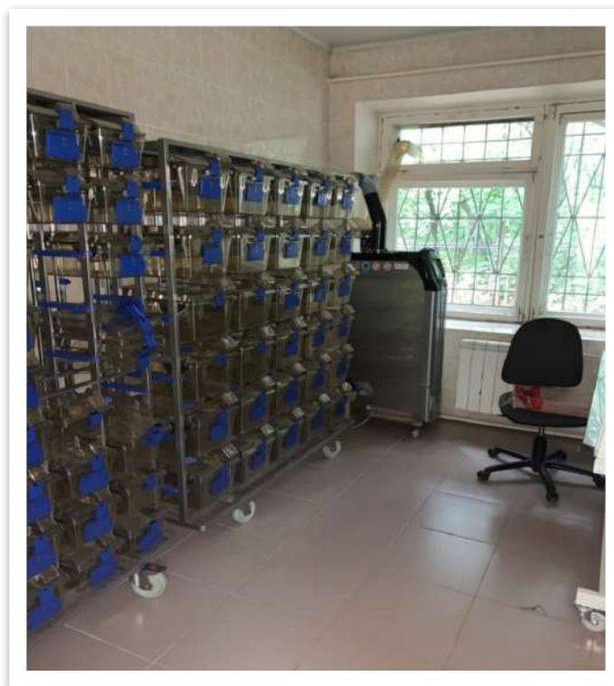
Рисунок 81 – Боксы для содержания лабораторных животных с централизованной системой приточно-вытяжной вентиляции
